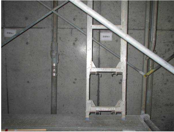
地域材型桧合板打設面(調査 No.4,5)
